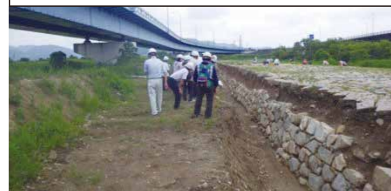
損傷が激しい二の荒手
