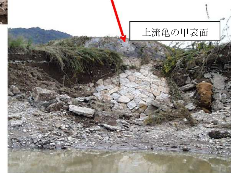
破堤部の上流亀の甲石張り表面を望む
