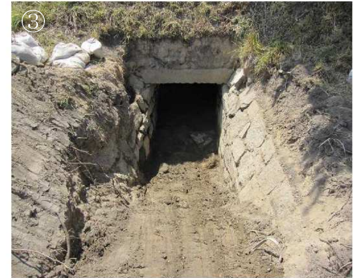
③ 呑口部掘削状況 (呑口部には石積みの水路跡が一部確認できる)
