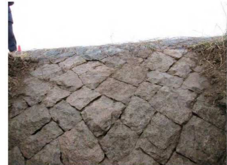
石材間の隙間が見られる 隙間は最大で 4cm 程度である
