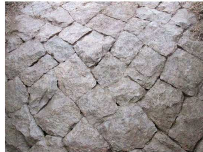
石材のずれが見られる ずれは最大で 5cm 程度である
