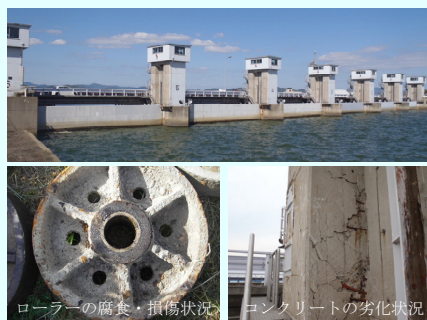
ローラーの腐食・損傷状況 コンクリートの劣化状況 老朽化が進む百間川河口水門
