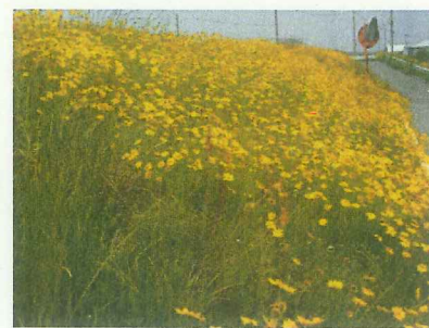
堤防 川裏側(5月撮影)
