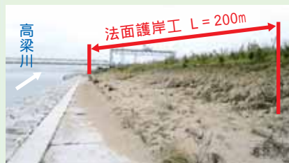
倉敷市玉島乙島地区の被災状況
