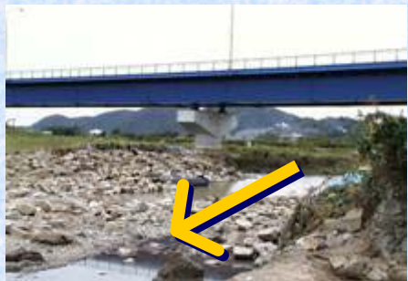
「二の荒手」の破壊状況
