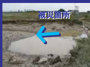
②被害の状況
