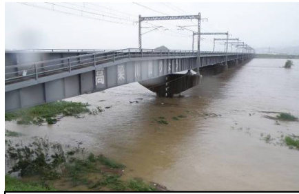
例:高水敷の冠水
