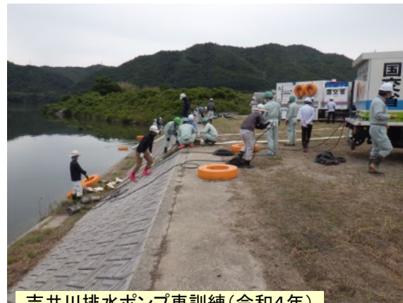
吉井川排水ポンプ車訓練(令和4年)
