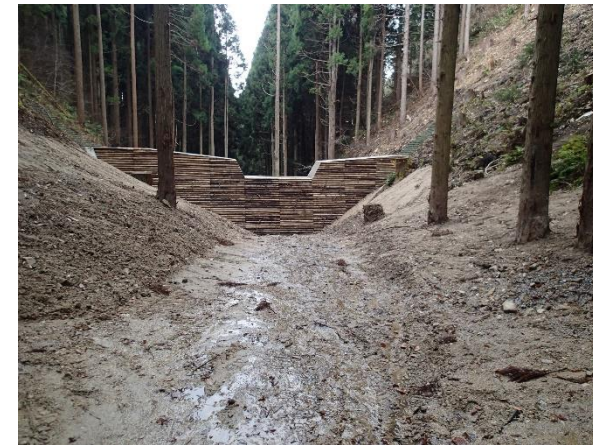
流木撤去の実施状況
