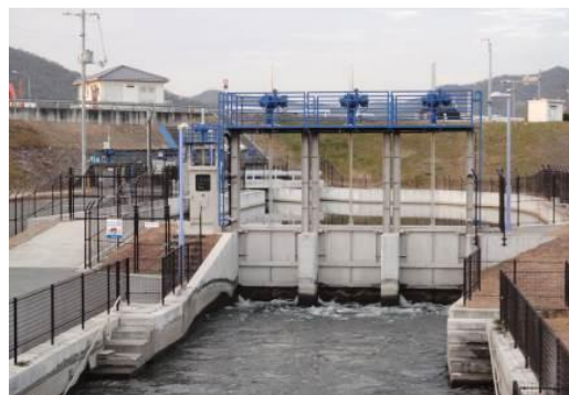
湛井堰ゲートの事前操作
