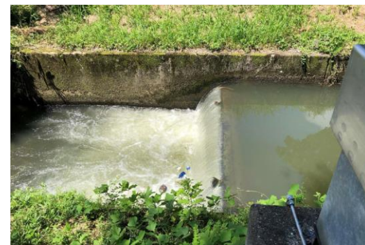
古地取水転倒堰の事前操作
