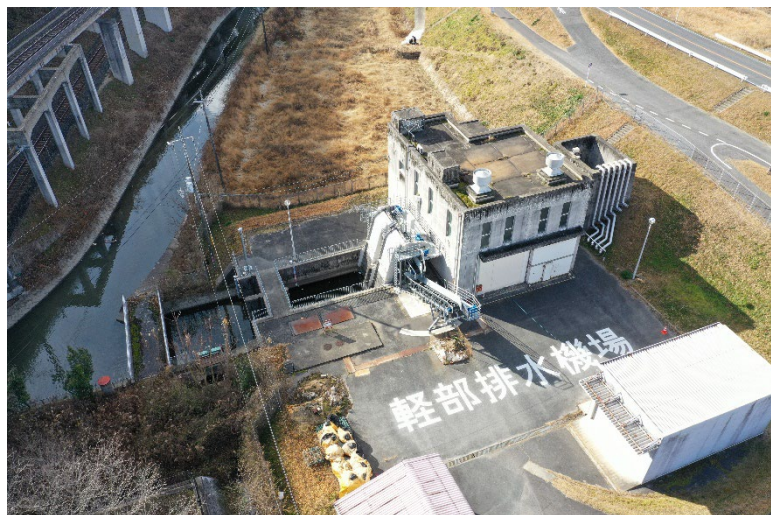
軽部排水機場の運転水位の見直し
