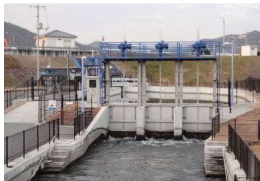
湛井堰ゲートの事前操作
