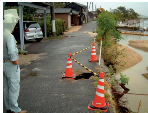
高潮被害状況 (平成16年8月:西幸西地先)
