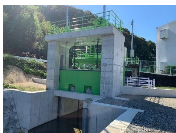
南部排水ポンプ場 (R4新設)
