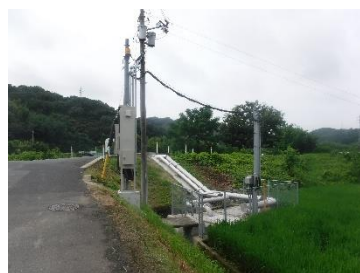
首高排水ポンプ場 (R3増設)
