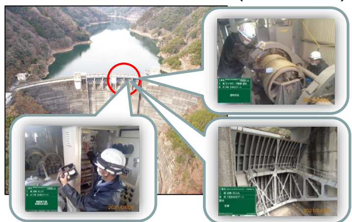
【ダム操作関係設備点検】
