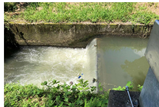
古地取水転倒堰の事前操作
