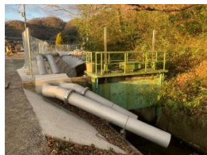
伊賀寺排水ポンプ場
