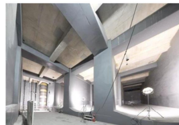
地下貯留ケース
