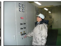
(ポンプの運転)
