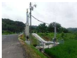
首高排水ポンプ場 (R3増設)
