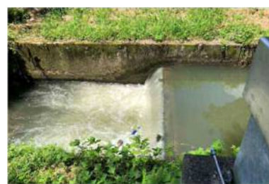
古地取水転倒堰の事前操作
