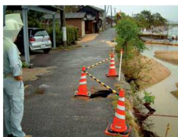
高潮被害状況 (平成16年8月:西幸西地先)
