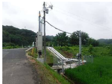
首高排水ポンプ場 (R3増設)
