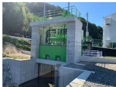
南部排水ポンプ場 (R4新設)
