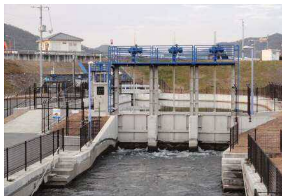
湛井堰ゲートの事前操作
