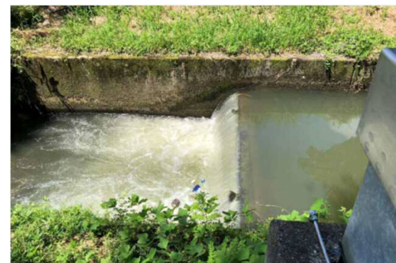
古地取水転倒堰の事前操作
