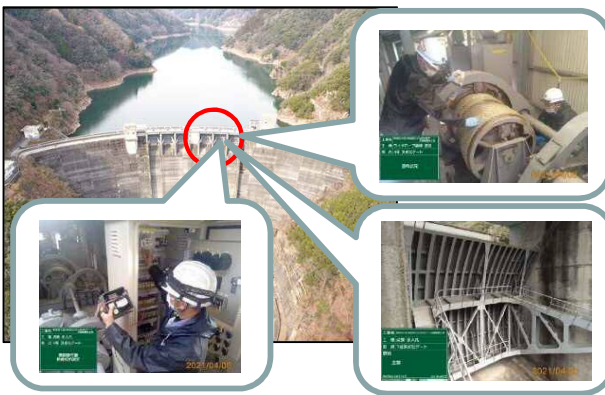
【ダム操作関係設備点検】
