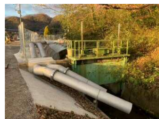
伊賀寺排水ポンプ場
