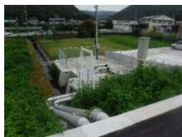
西町排水ポンプ場 (R3新設)
