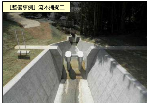
【整備事例】流木捕捉工
