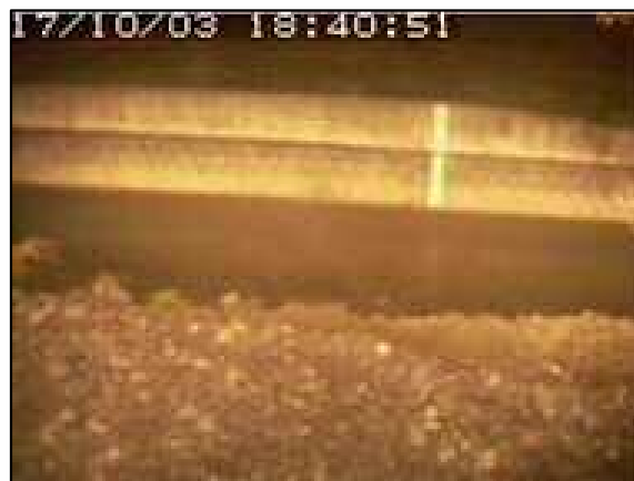
更新前(照明あり)
