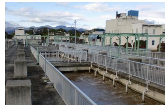
津山浄化センター
