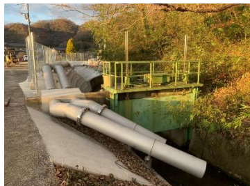
伊賀寺排水ポンプ場
