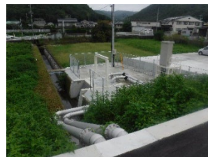
西町排水ポンプ場
