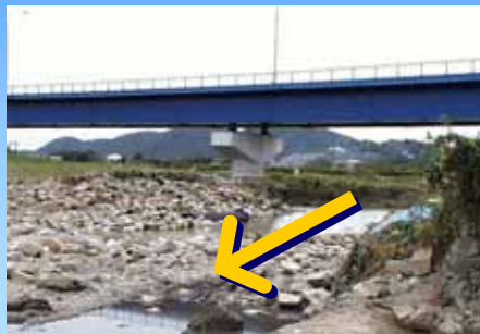
「二の荒手」の破壊状況
