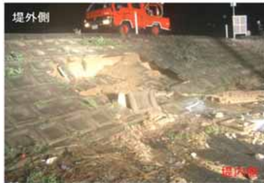
岡山県管理 海岸堤防被災状況
