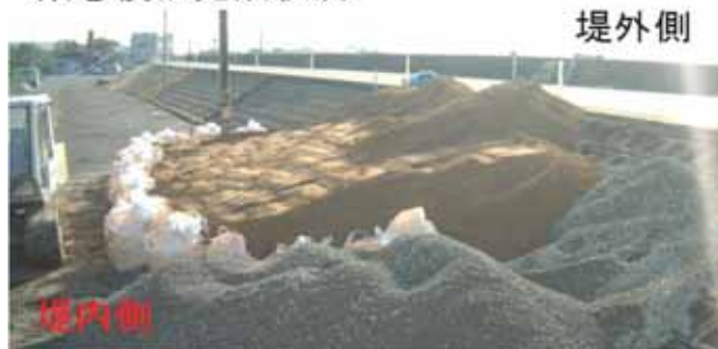
岡山県管理海岸堤防被災状況
