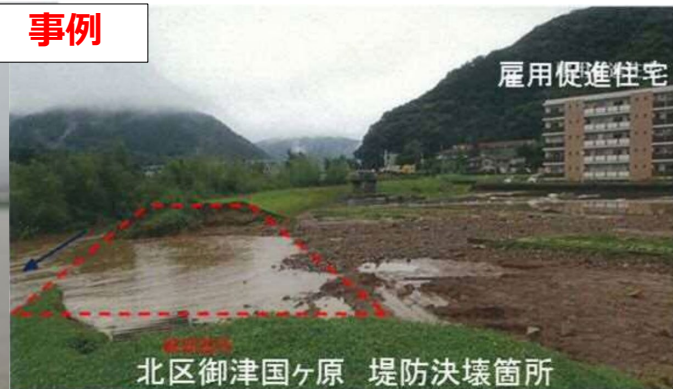
平成30年7月8日旭川堤防決壊箇所 (岡山市北区) 出典：平成30年7月豪雨における状況/岡山市
