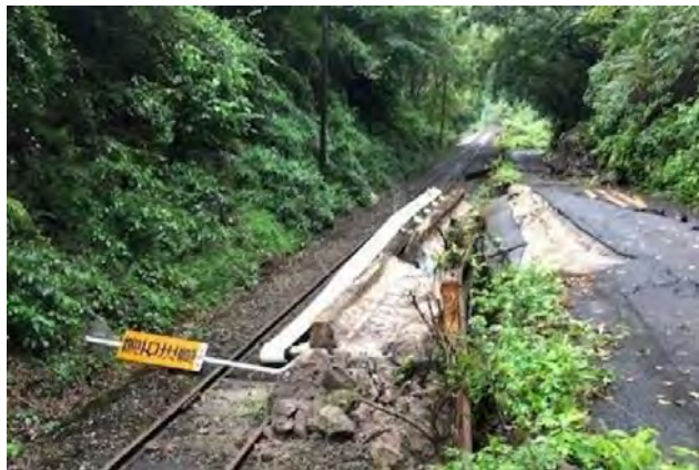
ガードレールが倒れ込んだJR姫新線新見一岩山間の線路＝4日午前(山陽新聞:JR西日本岡山支社提供)
