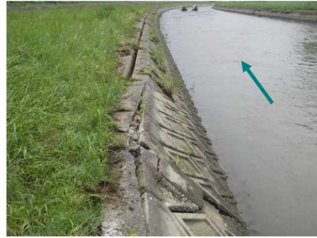
岡山市中区住吉町地区 被害状況 (H18. 7 梅雨前線豪雨)
