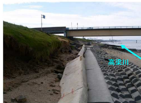
倉敷市連島町 被害状況 (H16.8 台風16号)
