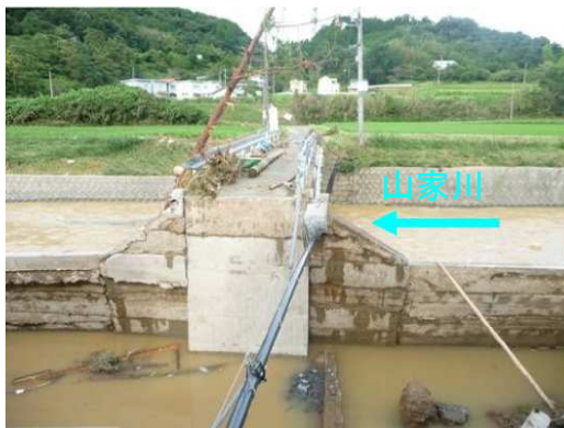
美作市江見 被災状況 (H21.8 台風9号)
