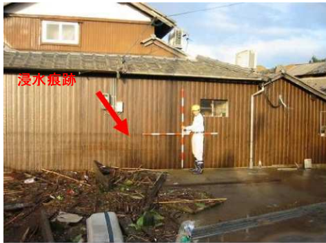
岡山市東区西幸西 家屋浸水痕跡 (H16.8 台風 16 号)
