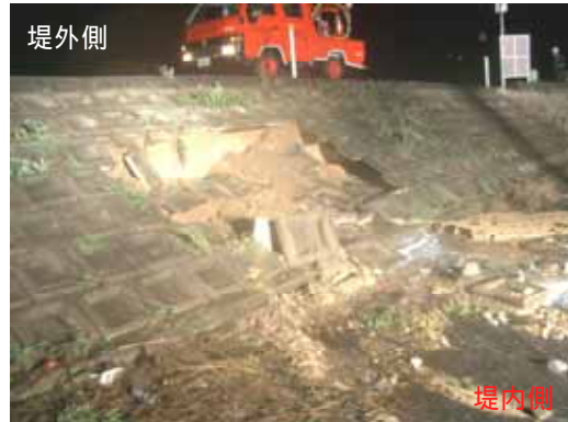
岡山県管理 海岸堤防被災状況
