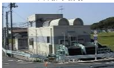
倉安川排水機場
