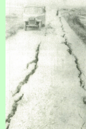
亀裂の入った堤防道路（旧三幡村付近）
