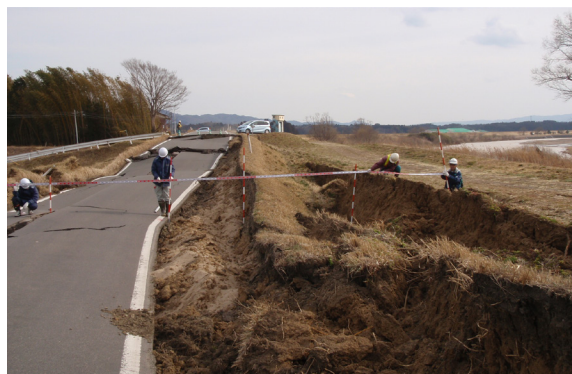
堤防沈下の事例（阿武隈川坂津田地区） 提供：東北地方整備局
