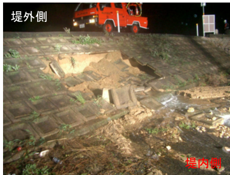
岡山県管理 海岸堤防被災状況
