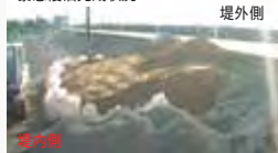
岡山県管理海岸堤防被災状況
