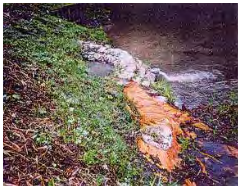
H10.10堤体漏水 旭川左岸15k400付近
