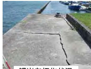
護岸老朽化状況
