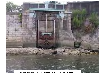
樋門老朽化状況
