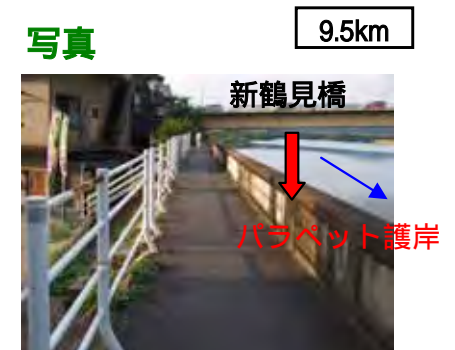
居住地側の地盤高が低く、パラペット護岸が機能しなくなれば、市街地が広く浸水する可能性がある
