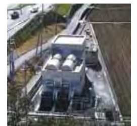
倉安川排水機場
