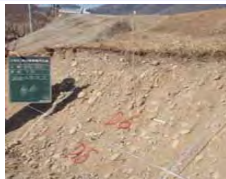
堤体に玉石が多数混在 旭川左岸15k400
