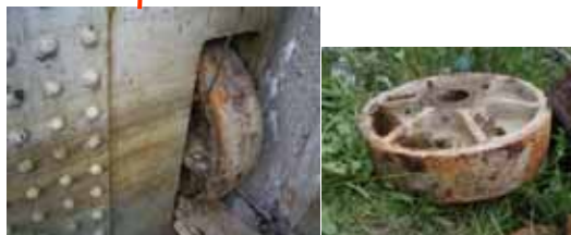
主ローラーの劣化・偏摩耗状況
