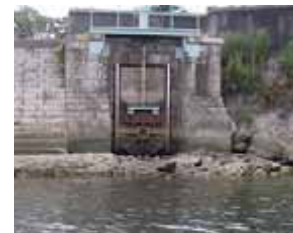
樋門老朽化状況
