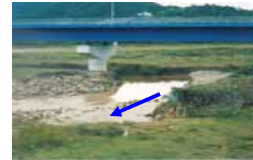
二の荒手の被災状況 (H10.10)
