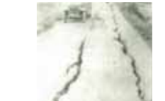
岡山県管理海岸堤防被災状況
