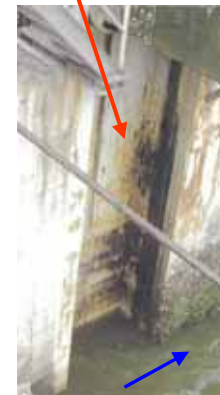
戸あたり部の塗装劣化状況
