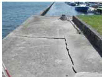
護岸老朽化状況
