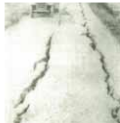
亀裂の入った堤防道路(三番村付近)
