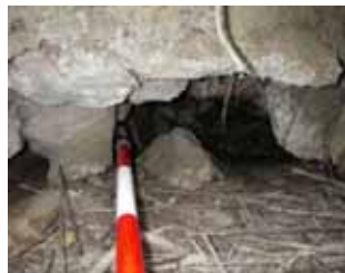
護岸空洞化状況
