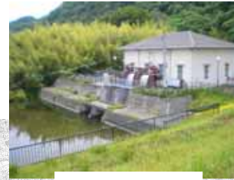
大原排水機場
