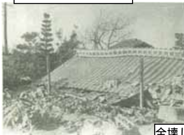
全壊した家屋(三番村付近)
