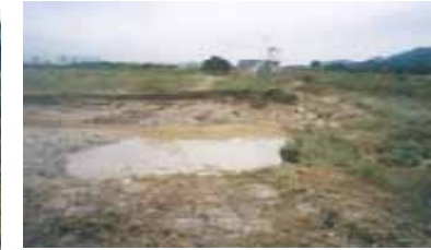
一の荒手の被災状況 (H10.10)
