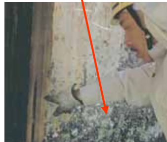
ゲート部の塗装劣化状況 (貝等の付着)
