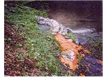
平成10年10月洪水時の堤体漏水 旭川左岸15k400付近
