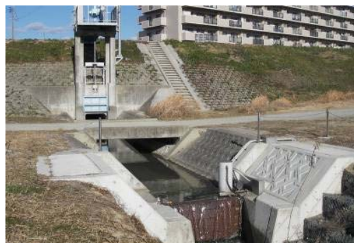
36 浄化施設設置後の藤原樋門からの排水状況
