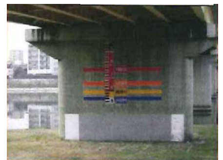
水位表示板（量水標）の事例
