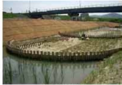
新田浄化施設
