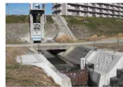
浄化施設を設置した「藤原樋門」
