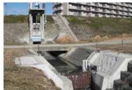
浄化施設を設置した「藤原樋門」
