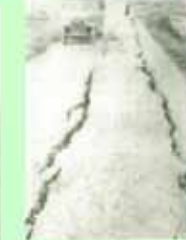
亀裂の入った堤防道路（旧三郷村付近）
