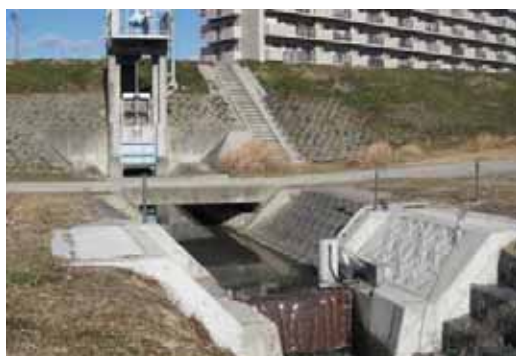
浄化施設を設置した「藤原樋門」
