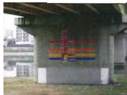
水位表示板（量水標）の事例
