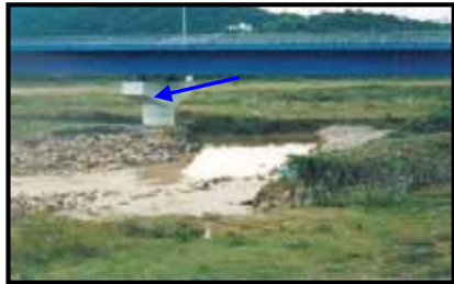
二の荒手被災状況
