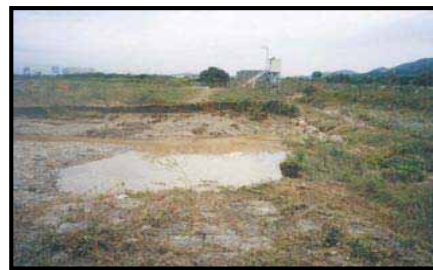
一の荒手被災状況
