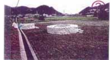
平成10年10月洪水時の基盤漏水 旭川16k400付近
