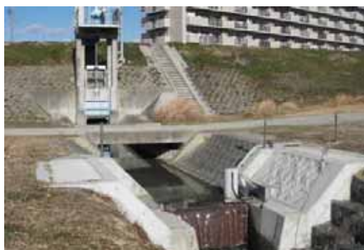
浄化施設を設置した「藤原樋門」
