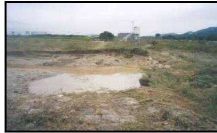
一の荒手被災状況
