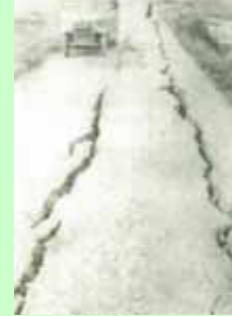
亀裂の入った堤防道路 （旧三蟠村付近）
