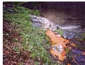
平成10年10月洪水時の堤体漏水 旭川左岸15k400付近
