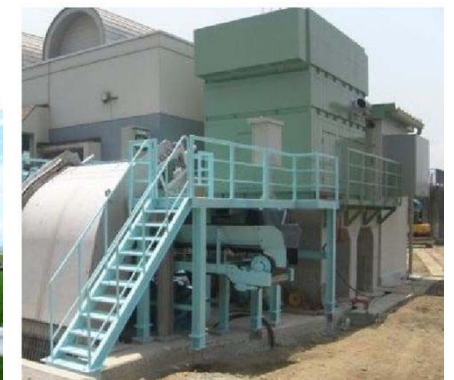
倉安川排水機場 平成26年7月ポンプ増設完了
