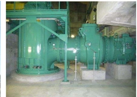
平井排水機場 平成24年3月ポンプ増設完了
