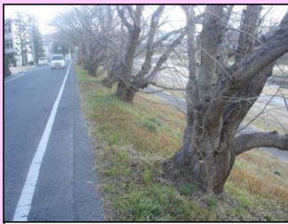
倒木の危険がありながら、植替えできない堤防
