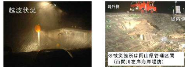
旭川の高潮による被災状況(平成16年8月高潮)
