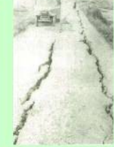
亀裂の入った堤防道路 （旧三幡村付近）
