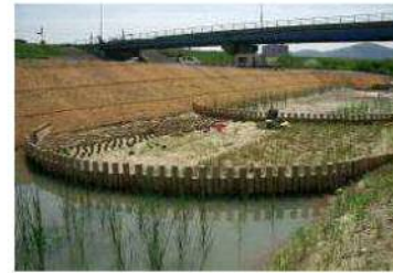
新田浄化施設
