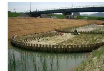
新田浄化施設
