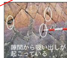
隙間から吸い出しが起きている
