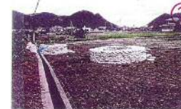
平成10年10月洪水時の基盤漏水 旭川16k400付近
