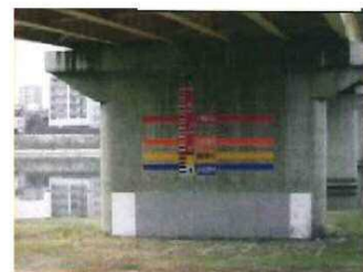
水位表示板（量水標）の事例
