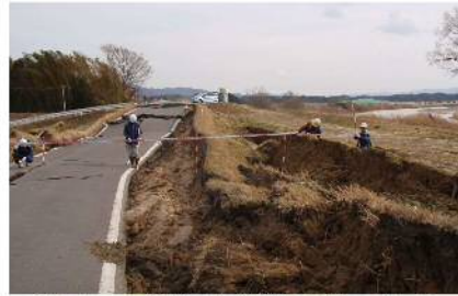
堤防沈下の事例（阿武隈川坂津田地区） 提供：東北地方整備局
