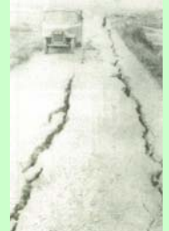
亀裂の入った堤防道路 （旧三幡村付近）
