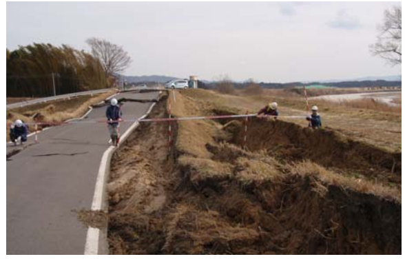
堤防沈下の事例（阿武隈川坂津田地区） 提供：東北地方整備局
