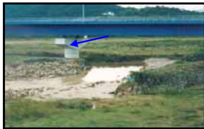
二の荒手被災状況
