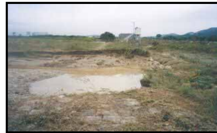
一の荒手被災状況
