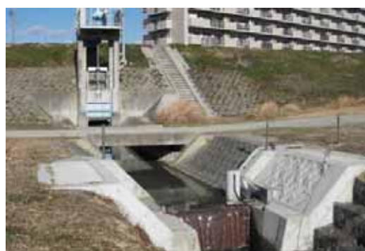
浄化施設を設置した「藤原樋門」
