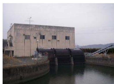
庄内川排水機場
