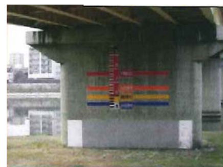
水位表示板（量水標）の事例
