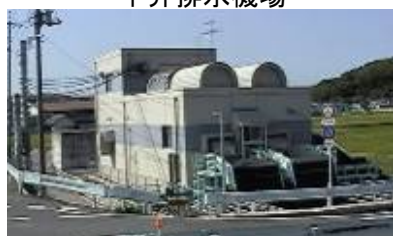
19 倉安川排水機場
