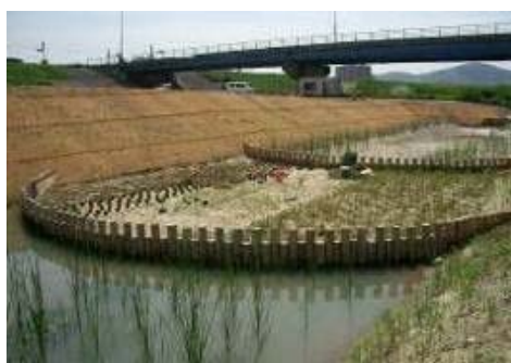
16 新田浄化施設
