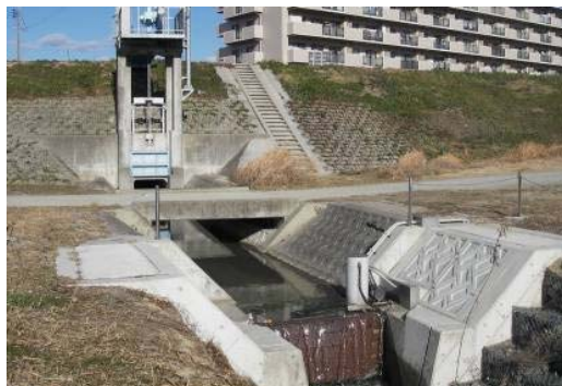
浄化施設を設置した「藤原樋門」
