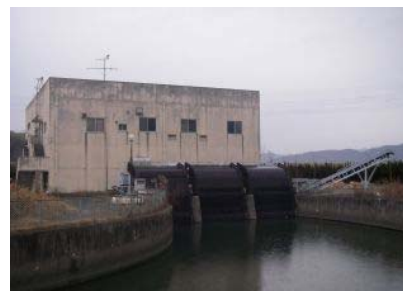
庄内川排水機場
