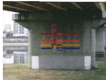
水位表示板（量水標）の事例
