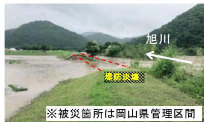
位置：岡山市内(国ヶ原地区：堤防決壊)
