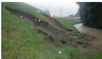
旭川の被災状況(平成23年9月洪水)
