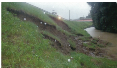
位置：岡山市内(玉柏地区：裏法崩れ)
