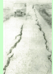
亀裂の入った堤防道路（旧三幡村付近）
