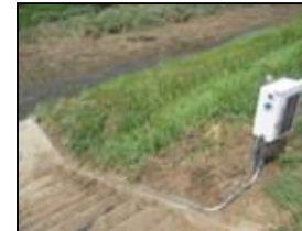
危機管理型水位計の設置状況
