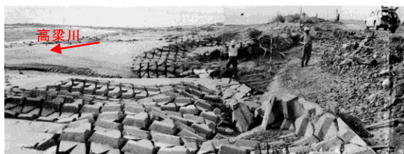
倉敷市鶴新田 低水護岸被災
